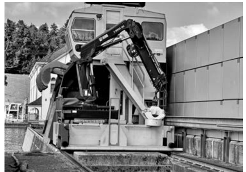
Der voll automatische Rechen des Kraftwerks Wynau
