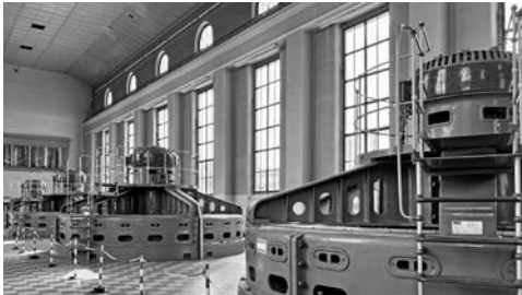
Die 4 Turbinen im Kraftwerk Schwarzhäusern
